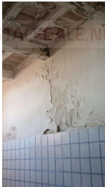
16. Perdita all'interno del bagno
