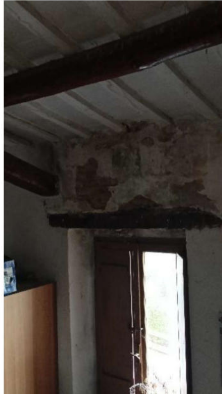
17. Perdita dal tetto fronte camera
