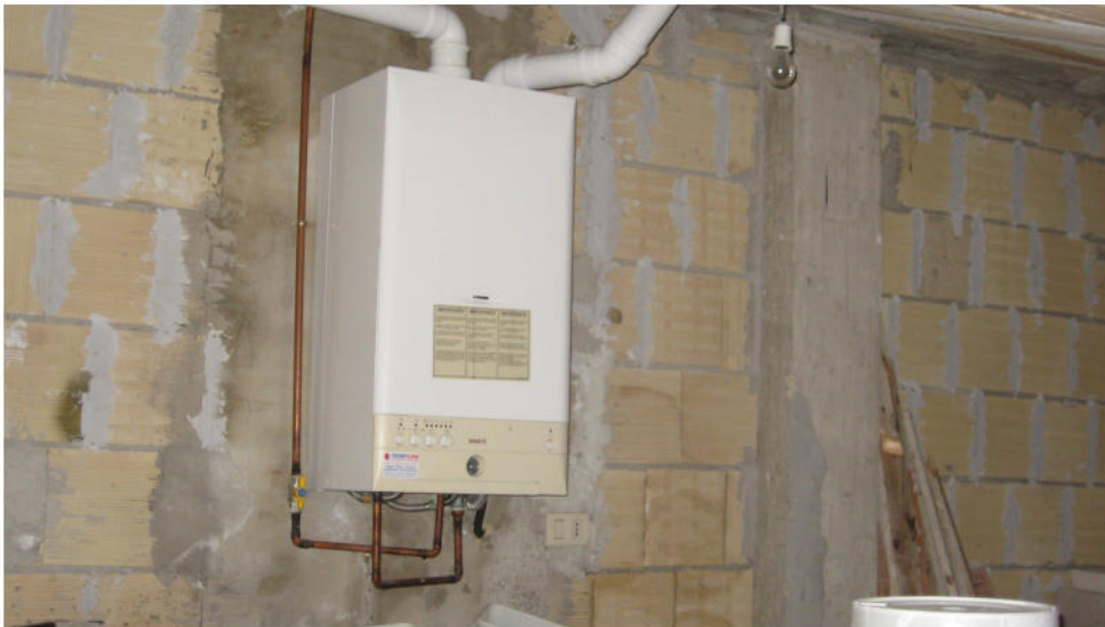
caldaia riscaldamento a metano
